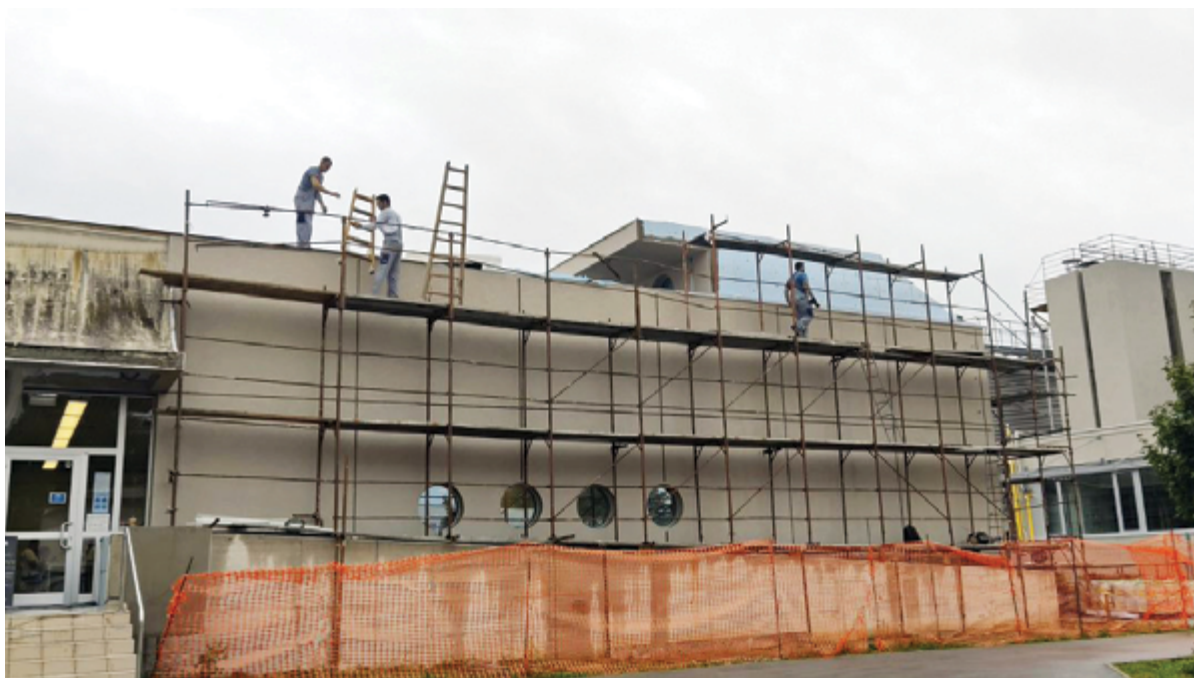
Delavci brez čelad na gradbenem odru na objektu Kuhinja SB Novo mesto, 5. 8. 2020.
